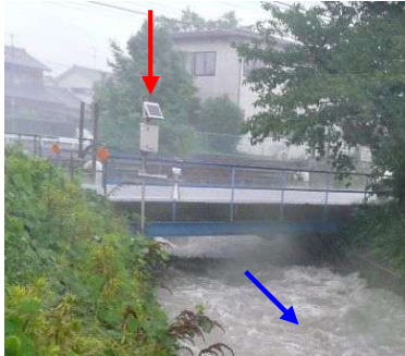
危機管理型水位計の設置状況
