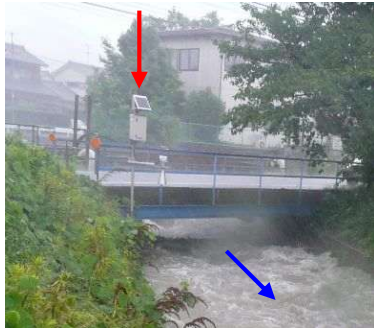
危機管理型水位計の設置状況
