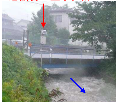
危機管理型水位計の設置状況
