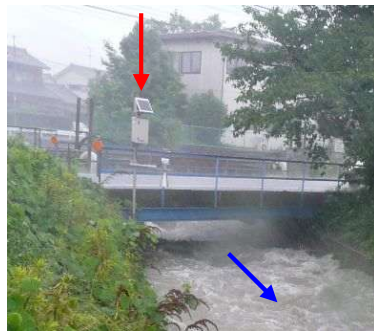
危機管理型水位計の設置状況
