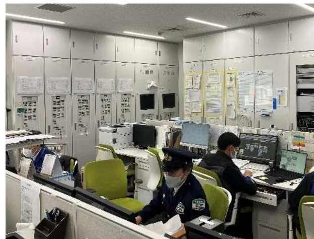
警備(中央管理室)
