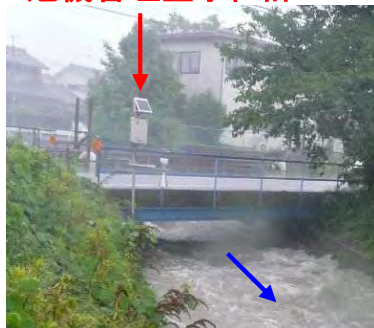
危機管理型水位計の設置状況
