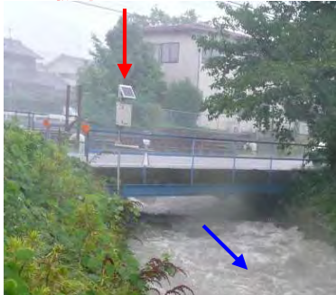
危機管理型水位計の設置状況
