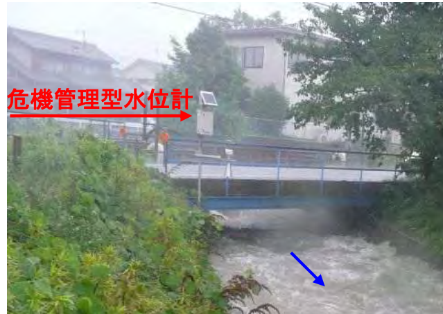
危機管理型水位計の設置状況
