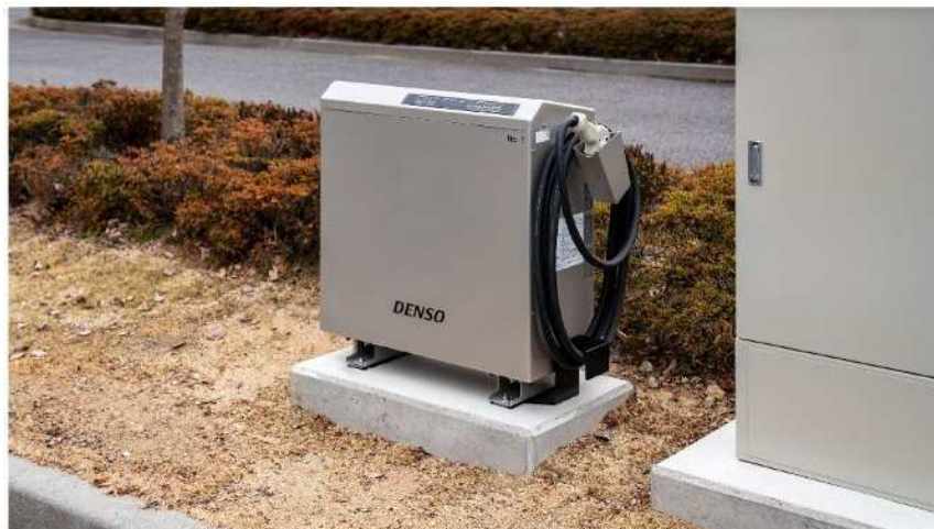
デンソー本社に設置されたV2H-充放電器
