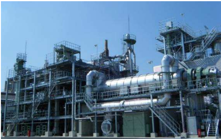
下水汚泥燃料化施設
