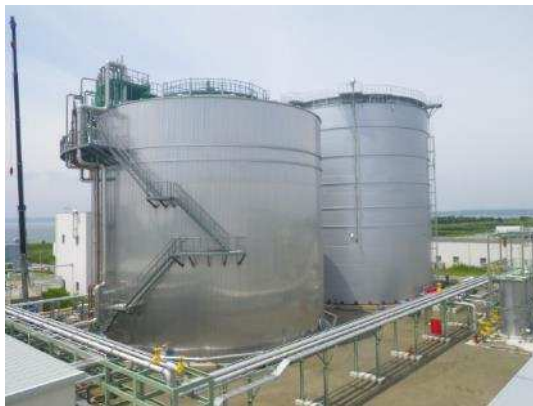
下水汚泥メタン発酵施設
