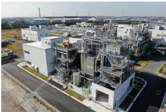
下水汚泥焼却炉
