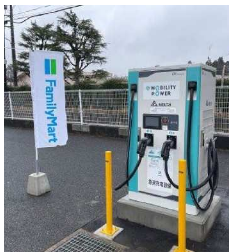
設置された充電器の写真
