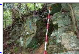
[亀裂が発達して落石 のおそれのある岩塊]
