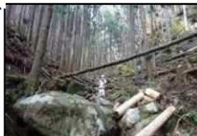
[不安定土砂礫の堆積]
