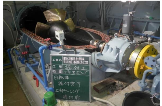
【農業用排水機の整備(弥富市)】
