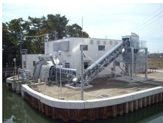
鷹居排水機場(あま市)
