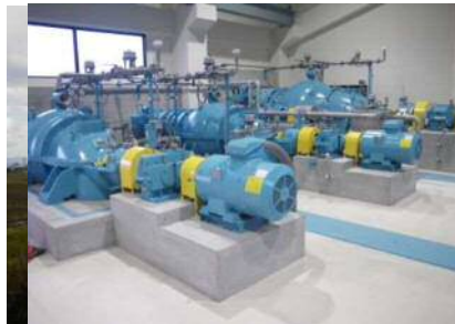
(五八排水機場ポンプ)
