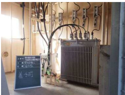
(老朽化した電気設備)
