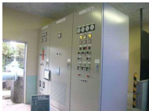
(更新された電気設備)
