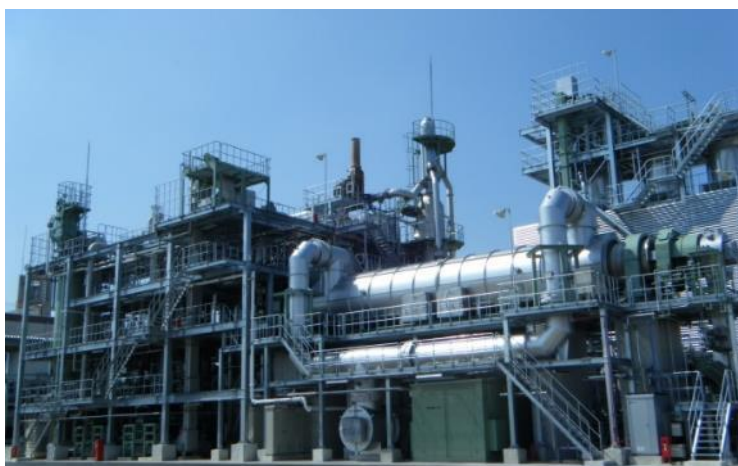
下水汚泥燃料化施設
