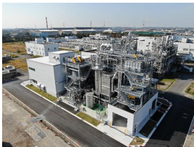
下水汚泥焼却炉
