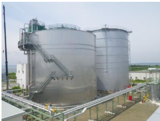
下水汚泥メタン発酵施設
