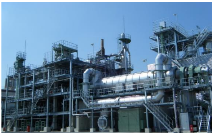
下水汚泥燃料化施設
