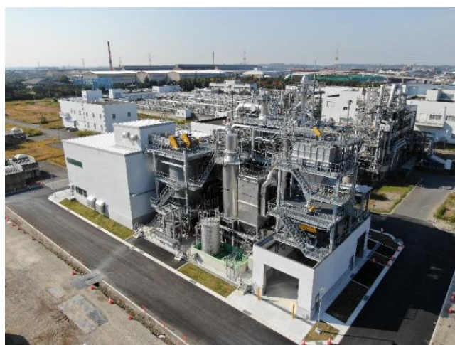
下水汚泥焼却炉
