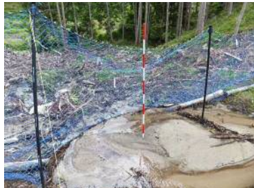
沢筋の土砂の堆積
