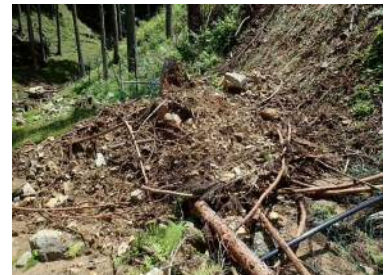
斜面からの崩土による損壊
