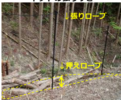
上はOK、下に隙間
