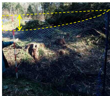
下はOK、高さが足りない
