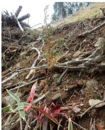
土が動いている急斜面
