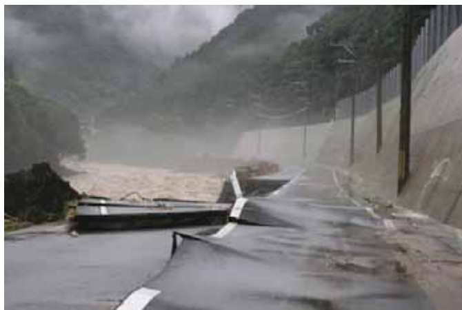
図表 4-2-5 県道 6 号線 養父宍粟線 豪雨で道路が寸断される
