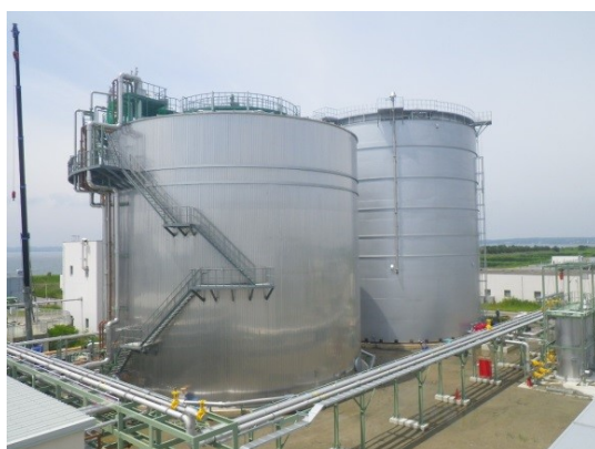
下水汚泥メタン発酵施設
