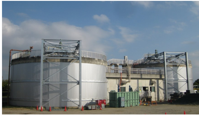
下水汚泥メタン発酵施設
