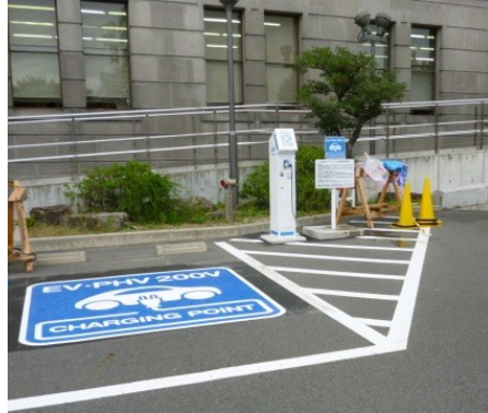
愛知県庁充電インフラ（本庁舎前）の状況
