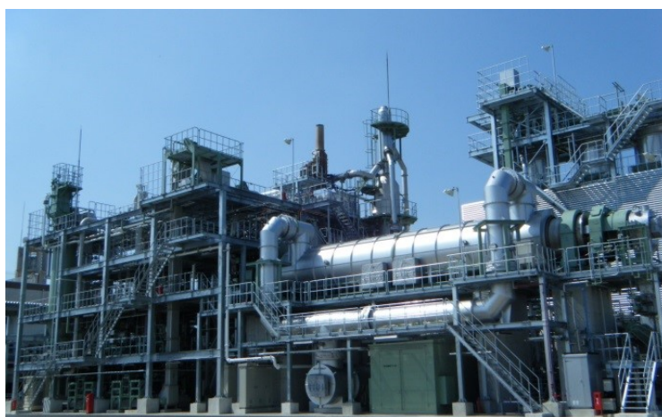
下水汚泥燃料化施設
