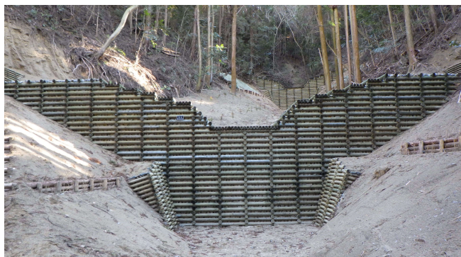
谷止工（瀬戸市）
