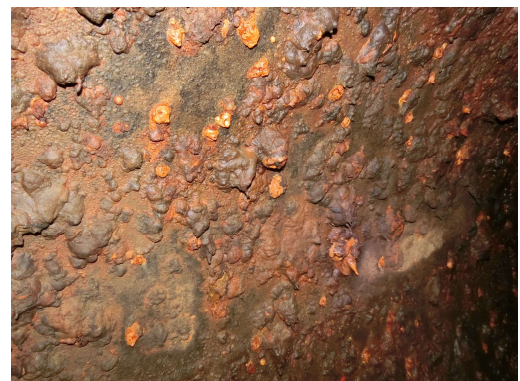
パイプラインの腐食状況(鋼管内面)
