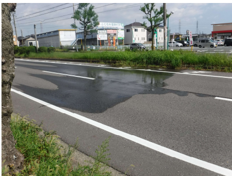
幹線道路下での漏水事故 (一宮市内)
