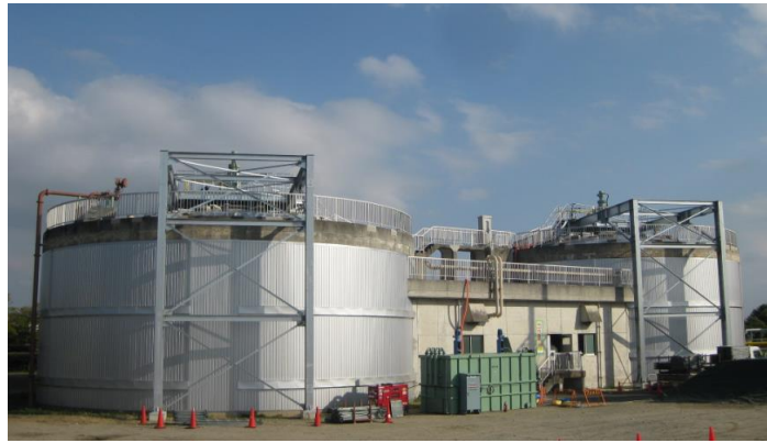
下水汚泥メタン発酵施設
