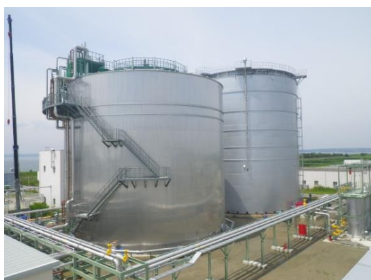
下水汚泥メタン発酵施設
