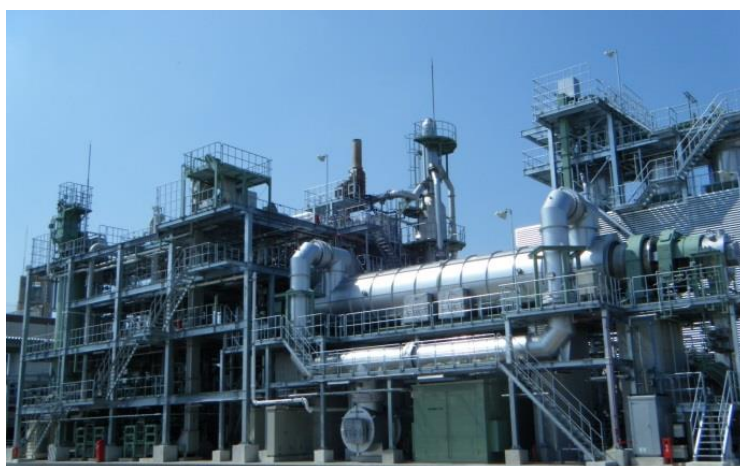
下水汚泥燃料化施設
