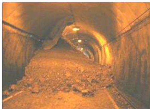
経年劣化による背面空洞が原因とされるトンネルの崩落。<旧(国)151号太和金トンネル(東栄町・豊根村;2011.8発生)>
