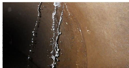
パイプラインの破損、漏水の状況
