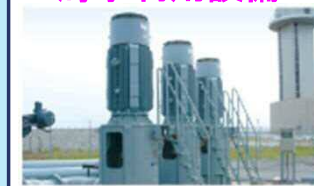
海水利用設備
