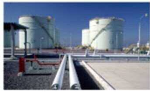
航空機燃料給油施設
