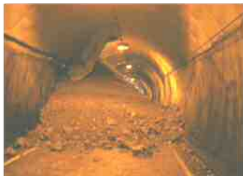
経年劣化による背面空洞が原因とされるトンネルの崩落。<旧(国)151号太和金トンネル(東栄町・豊根村;H23.8発生)>
