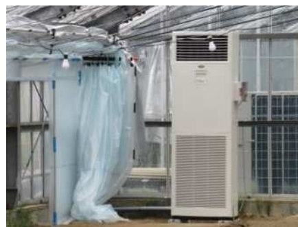
ヒートポンプの導入（豊橋市）
