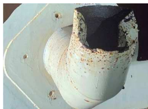
漏水箇所（当初想定）
