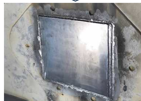
鉄板閉塞箇所
