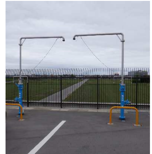
給水車用給水栓
