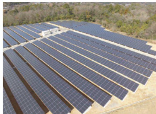
太陽光発電設備（犬山浄水場）
