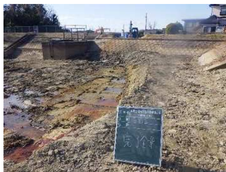
豊田市 (貯留施設整備状況)
