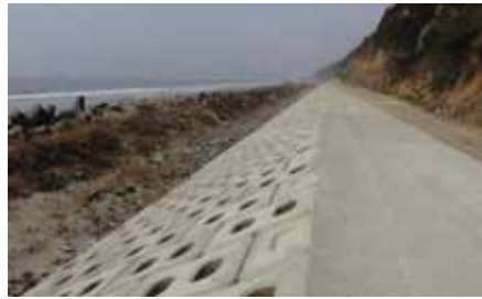
④傾斜護岸（田原・豊橋海岸〔久美原〕）
