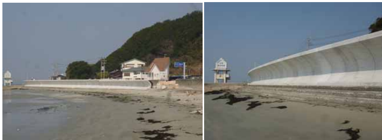
老朽化した既設堤防の前面に大型波返し護岸を設置（南知多海岸）
