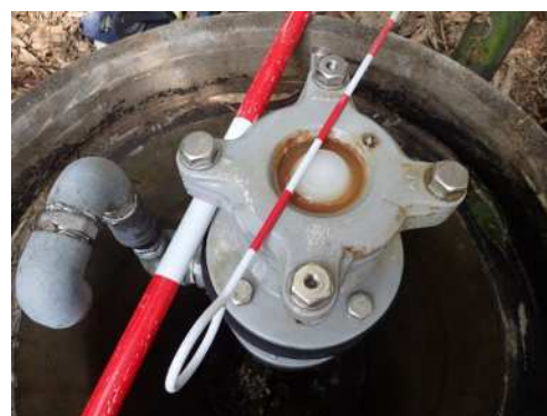
写真-3 水が到達後、止水されている状況
