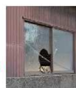
窓が割れた 管理不全空家
