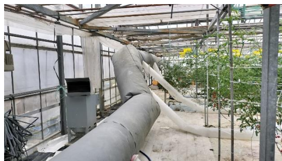
写真 送風ダクト
