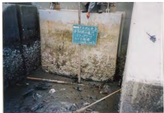
ヘドロの堆積（フラップゲート）
