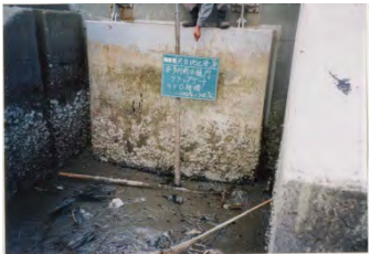
ヘドロの堆積（フラップゲート）
