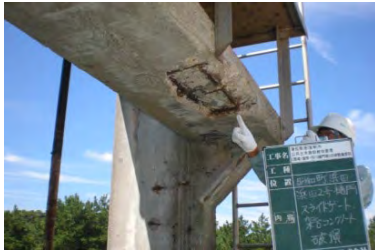
破損（スライドゲート）
