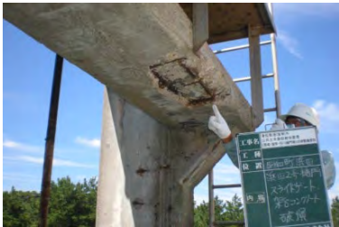
破損（スライドゲート）
