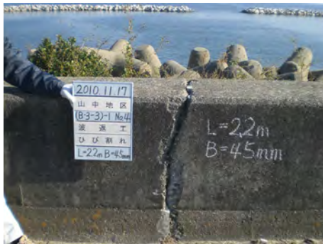
波返し工ひび割れ（三重県鈴鹿市）
