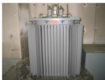
高圧トランス
