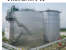
矢作川浄化センター (消化槽)
