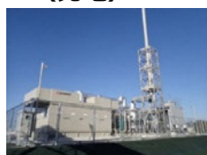
豊川浄化センター (ガスエンジン発電機)
