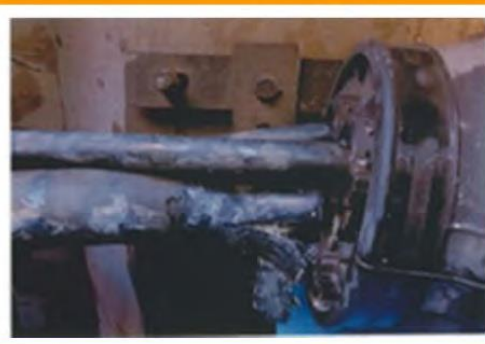
地下ケーブルの損傷
