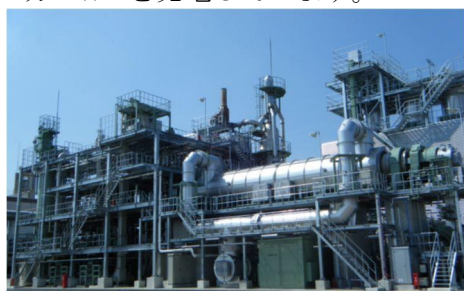
污泥燃料化施設全景
