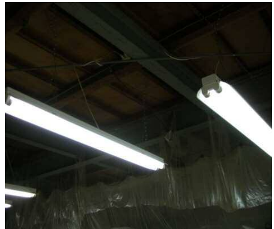
自然光型の蛍光灯による作業場の照明 (H26.4.28 新城市)
