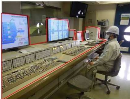
⑤青木川放水路：電気機械設備工
