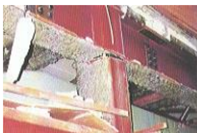
柱頭部が破断した鉄骨柱
