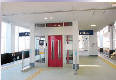
駅に設置されたエレベーター
