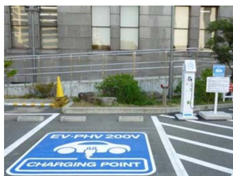
愛知県庁充電ステーション（県庁本庁舎正面玄関横（北側）の駐車場の一画）
