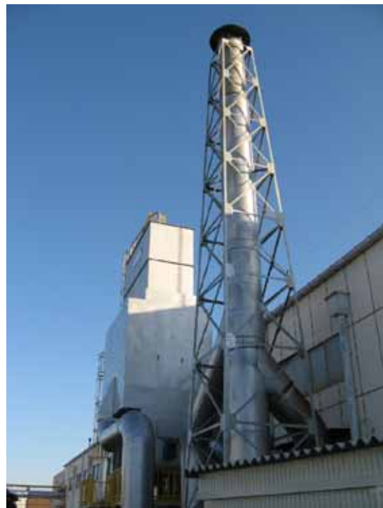
図3 フッ素除去設備の全体像
