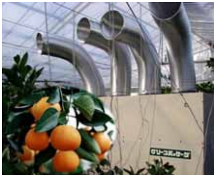
ハウスみかん栽培施設に導入 されたヒートポンプ
