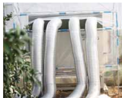
設置されたヒートポンプ （温度ムラを防ぐため、吹き出し口をダクトで延長）
